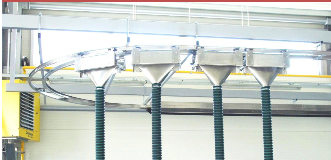
odsávání na lince STK – detail dráhy s odsávacími vozíky a hadicemi
