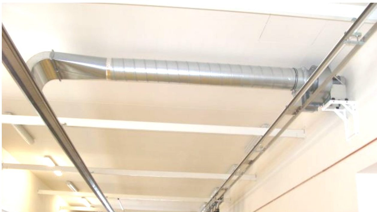
potrubí od odsávací dráhy mimo budovu
